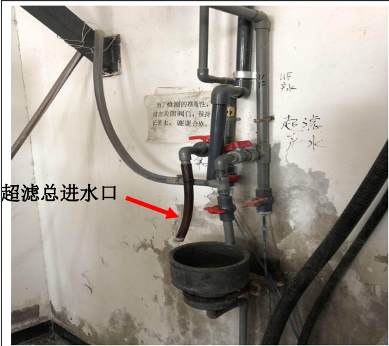
图 1 超滤装置总进水口
