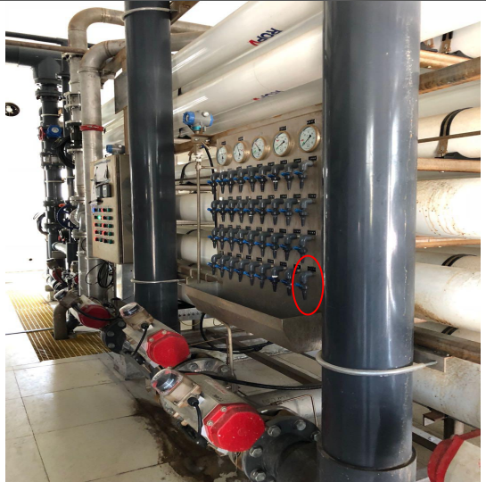
图4 浓水反渗透装置出口（总产水取样点）
