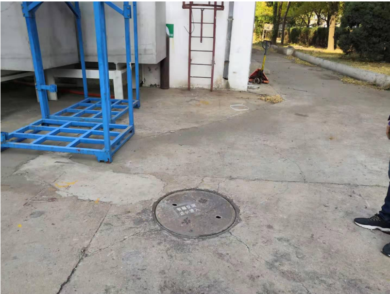
图 5 厂区废水总排口
