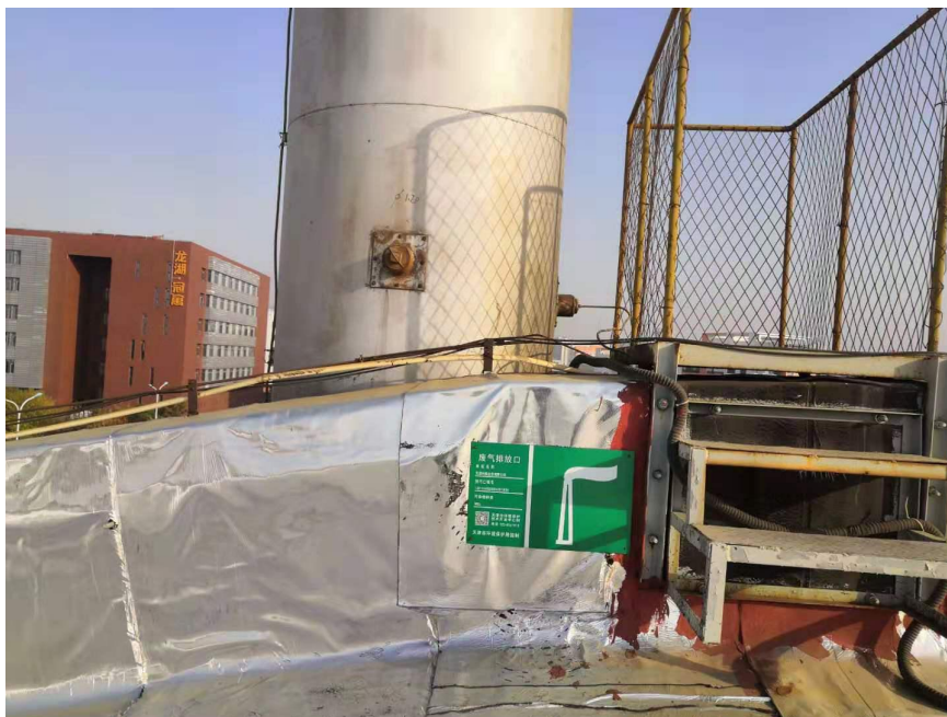
图8 废气排放口环保标示牌
