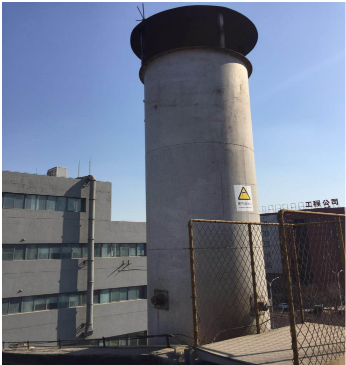
图 4 废气排气筒 P 1
