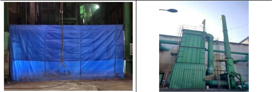
图 2 本项目新建密闭喷漆室
