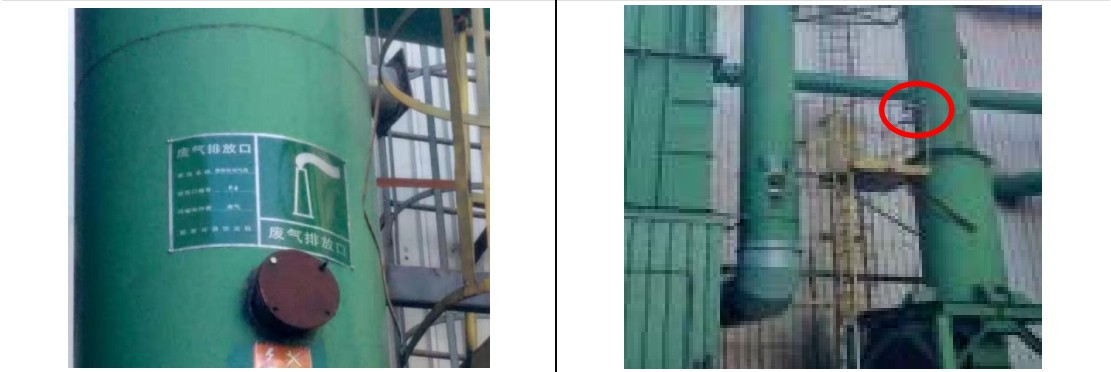
图 4 排气筒 P4 及标识牌
