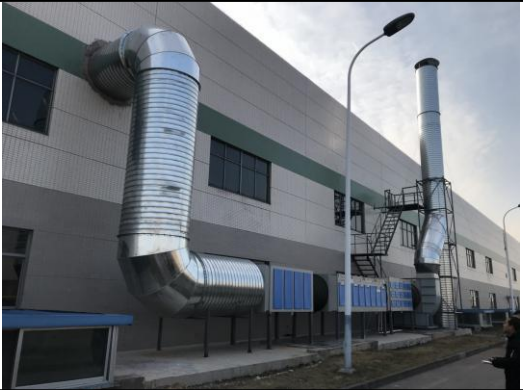
图 10 有机废气排气筒
