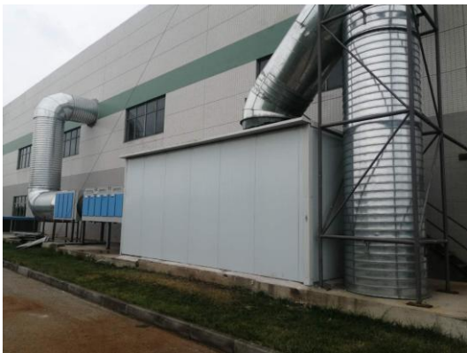
图 3 环保设施风机加装隔声措施
