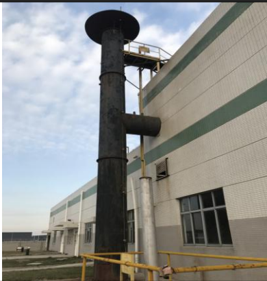
图 6 锅炉废气排气筒
