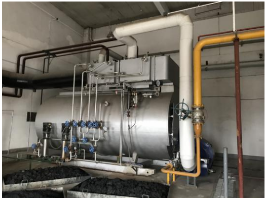
图 5 锅炉及低氮燃烧系统
