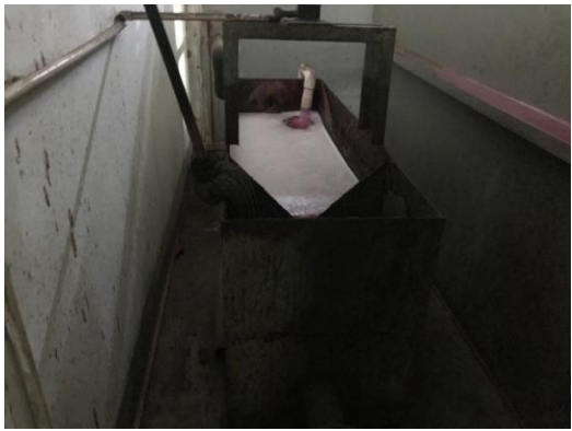
图 4 生产废水处理站排放口
