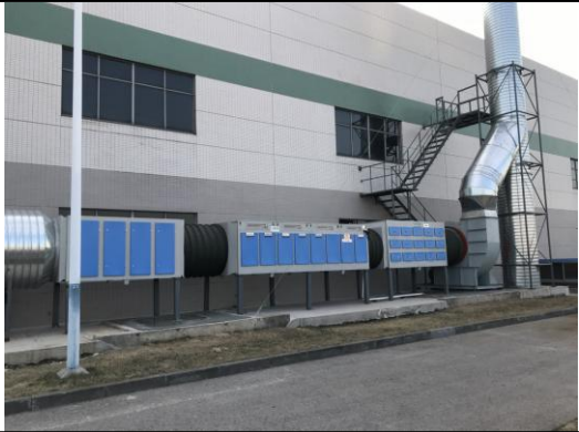
图 9 有机废气净化设施
