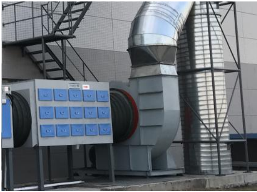
图 1 环保设施风机管道软连接
