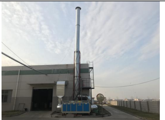
图 4 恶臭气体净化设施及排气筒
