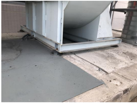
图 2 环保设施风机基础减振
