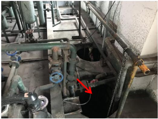
图 2 油墨废水进水贮池
