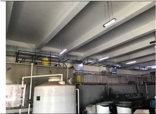
图 1 废水处理站废气收集管道
