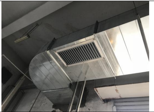
图 2 废水处理站废气收集口
