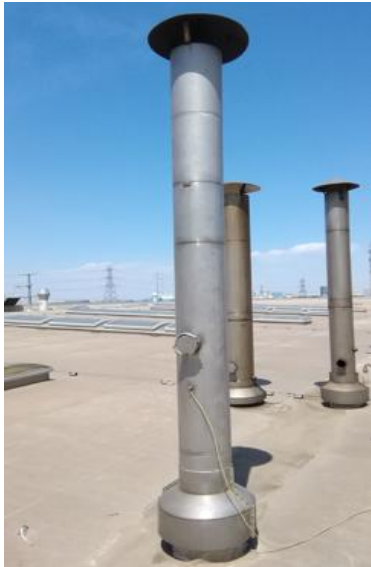
热处理燃烧废气排气筒P 7
