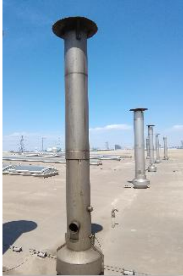
热处理燃烧废气排气筒P 5
