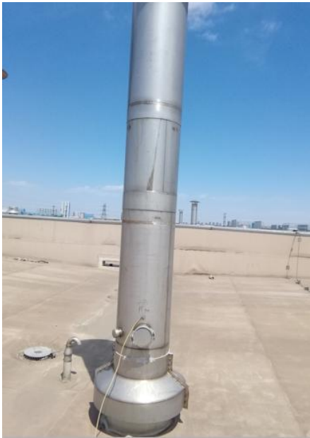
热处理燃烧废气排气筒P 1
