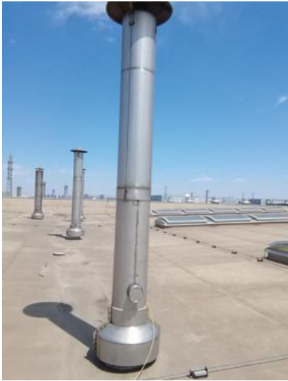
热处理燃烧废气排气筒P 4
