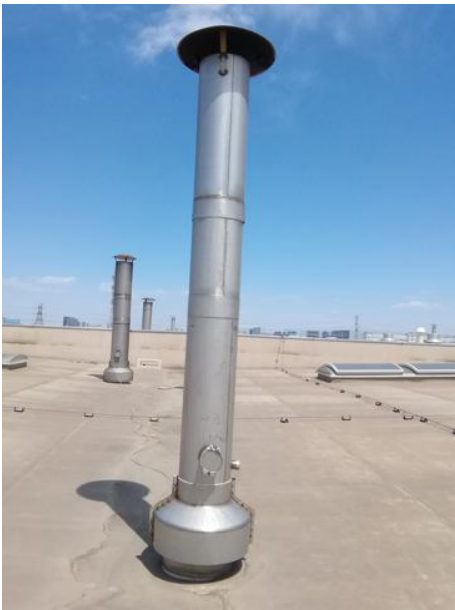
热处理燃烧废气排气筒P 2
