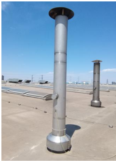
热处理燃烧废气排气筒P 8
