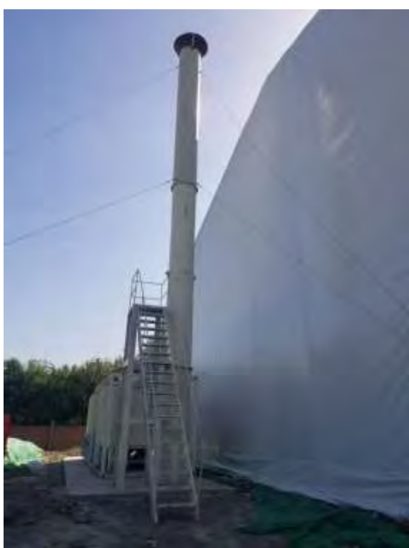
密闭修复车间环保设施及排气筒
